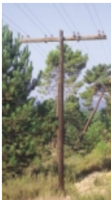
Poste de tendido eléctrico.
