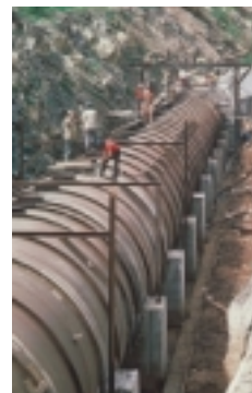
Operarios trabajando en la construcción de una central hidroeléctrica para la producción de energía. (Foto BID.)
