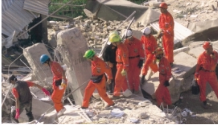
Descombrar. Un grupo de rescate despeja el área afectada tras un terremoto en Atenas, Grecia.
