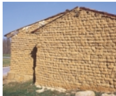
El adobe se emplea para la construcción de paredes como la de la imagen.
