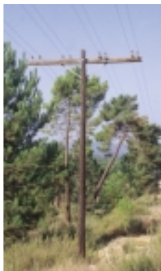
Cables de un poste de electricidad.
