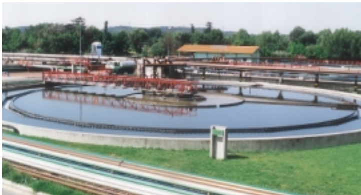
Instalaciones para la purificación del agua.
