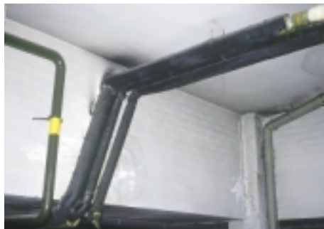
Conducto de agua.
