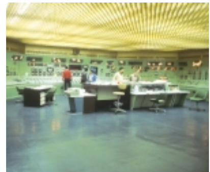
Sala de control de una central nuclear .
